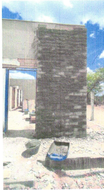
Foto 07- CHAPISCO APLICADO EM ALVENARIA (COM PRESENÇA DE VÃOS) E ESTRUTURAS DE CONCRETO DE FACHADA, COM EQUIPAMENTO DE PROJEÇÃO. ARGAMASSA TRAÇO 1:3 COM PREPARO EM BETONEIRA 400 L. AF 06/2014
