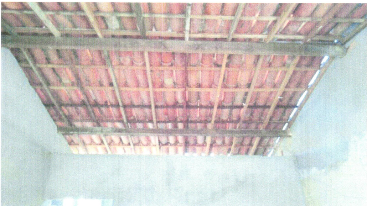
FOTO 30 - Retelhamento em cobertura com telha ceramica tipo canal comum, Itabaiana ou similar.
